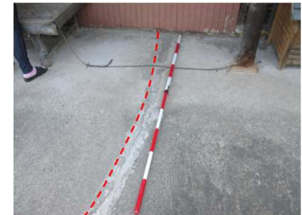
②民家土間コンクリートの開き (開口部の補修跡)
