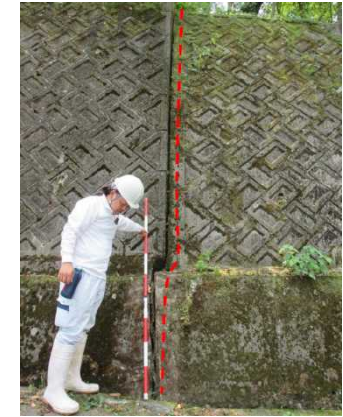
①町道擁壁の変状
