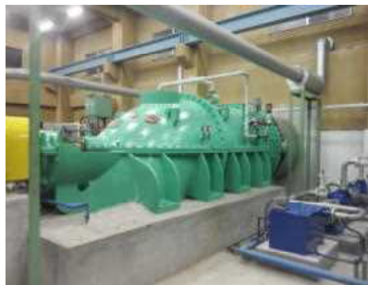
オーバーホールされた排水ポンプ （堀江排水機場）
