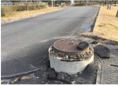
平成28年熊本地震 体育館周りの隆起したマンホール 出典：熊本災害デジタルアーカイブ 提供者：熊本県益城町
