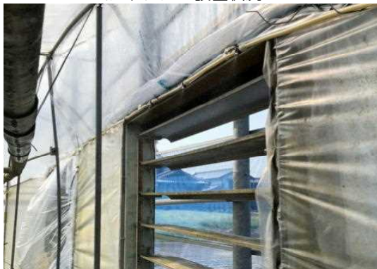
ミストノズル設置状況
