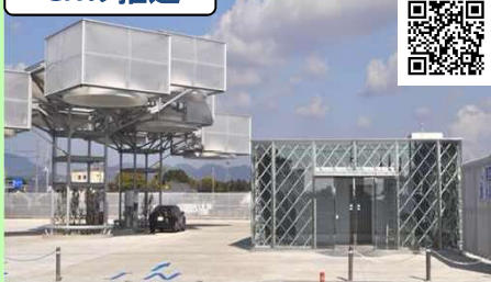
「地産水素」を活用した「製造・供給一体型」 固定式水素ステーション
