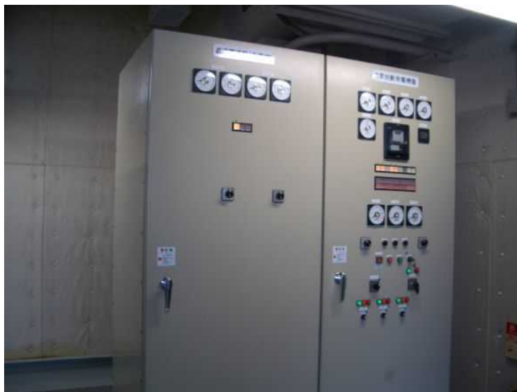
自家発電装置
