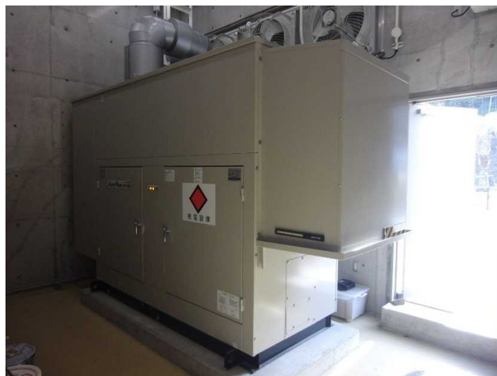
自家発電設備
