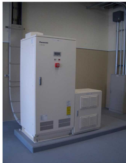
蓄電システム
