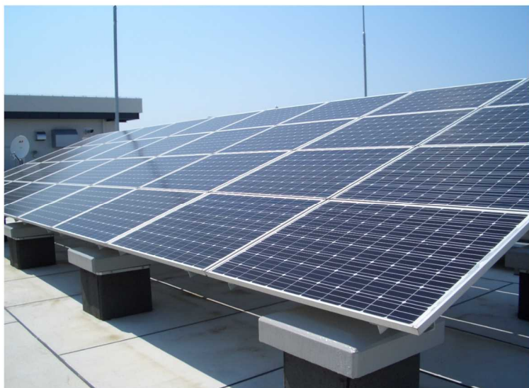
太陽光パネル
