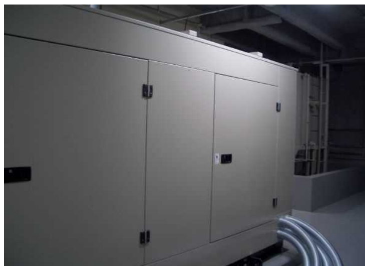
非常用発電機
