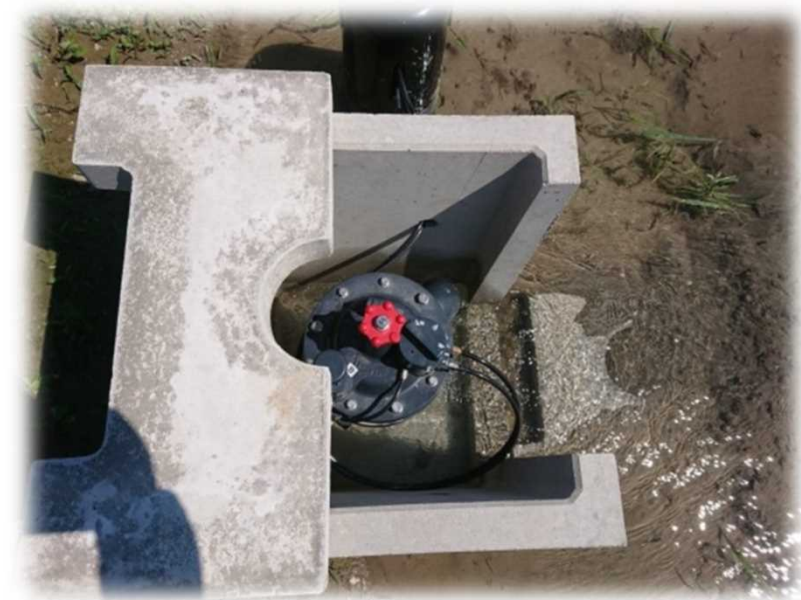
用水路工(自動給水栓)
