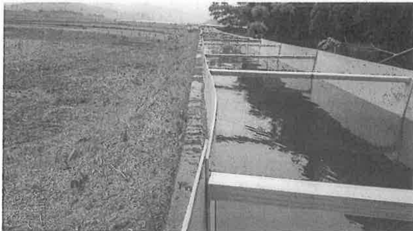
図4-6 合板で応急処置を行った水路
