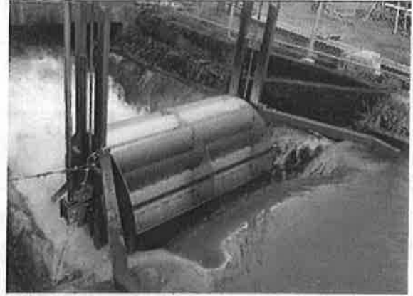
小水力発電施設
