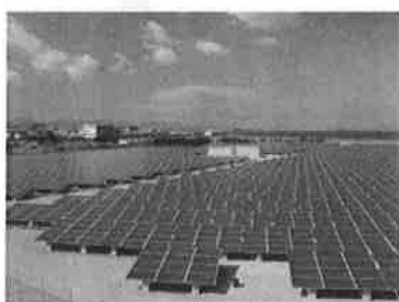
マリンピア沖洲太陽光発電所
