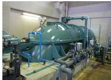
オーバーホールされた排水ポンプ （宮島排水機場）
