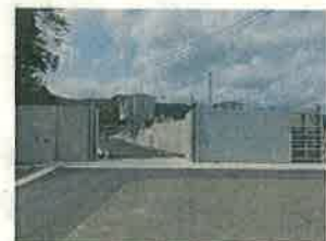
電動陸閘（牟岐漁港）
