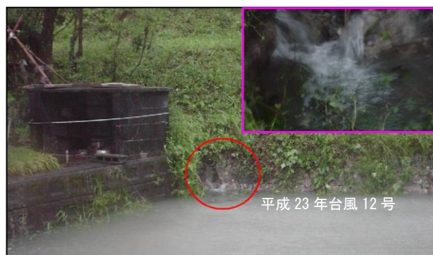
写真 2-4 海部川における堤防漏水の状況
