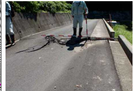
① 路面の被災状況
