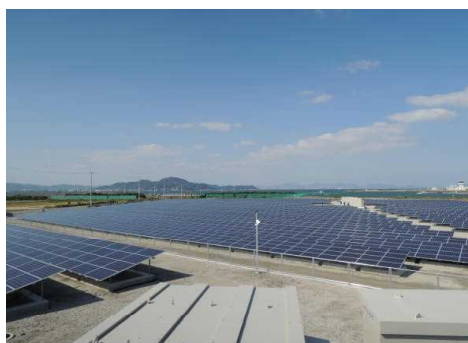
「和田島太陽光発電所」
