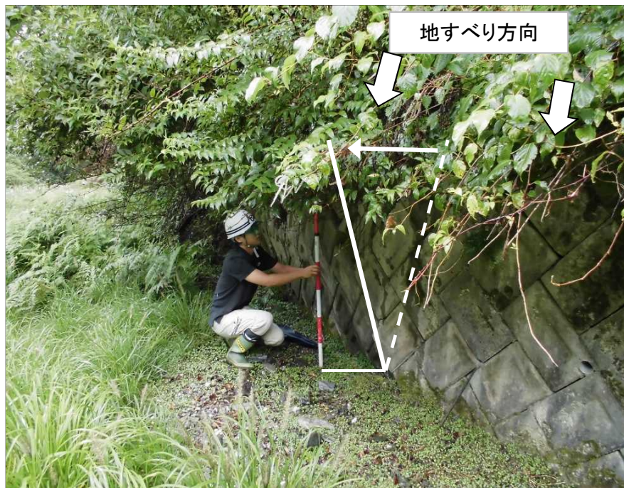
山留めブロック擁壁の傾き (阿佐工区終点)
