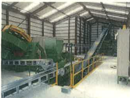
木質バイオマス燃料チップ製造施設
