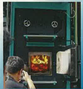
木質バイオマスボイラー
