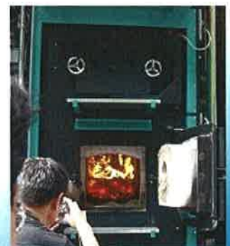
木質バイオマスボイラー
