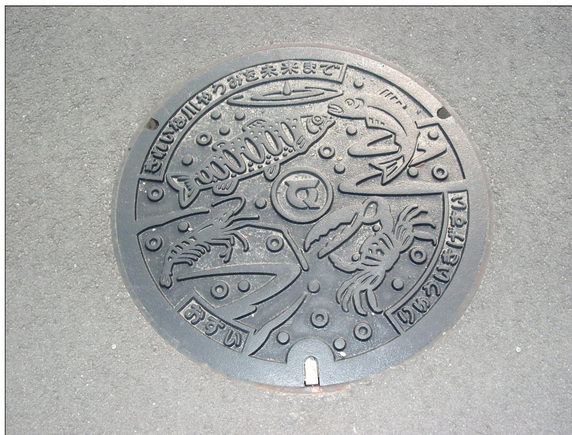
旧吉野川流域下水道のマンホール
