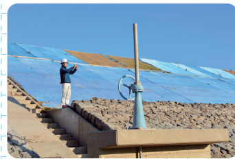
現場では監督業務を行う。工事が計画通りに進んでいるか、その確認作業でもICT機器が役立つ。
