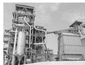
※クラボウ徳島バイオマス発電所
