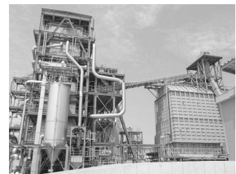
※クラボウ徳島バイオマス発電所
