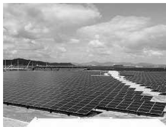
※企業局和田島太陽光発電所
