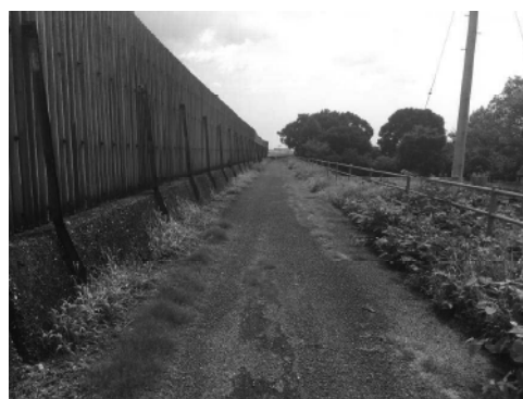
路面状況(舗装の割れ・雑草)
