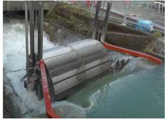
小水力発電施設
