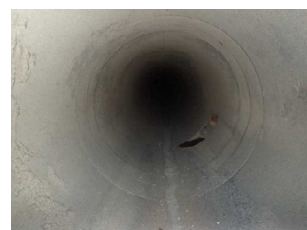
老朽化した管
