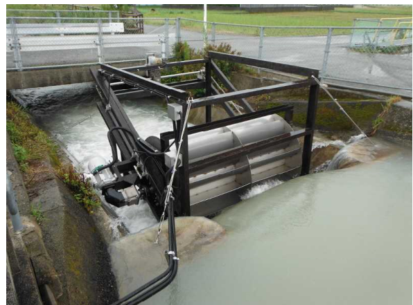
【施策３－１】 水路に設置した小水力発電装置
