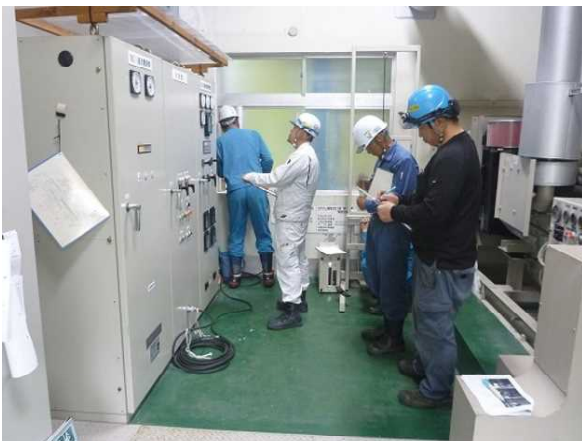
【施策１－１】 非常用発電施設の試運転点検の状況
