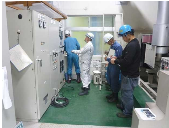
非常用発電施設の試運転と点検(正木ダム)
