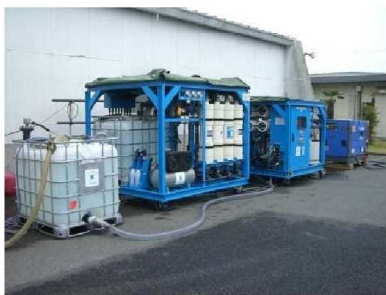
可搬式海水淡水化装置を設置
