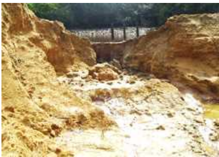
老朽化して決壊したため池
