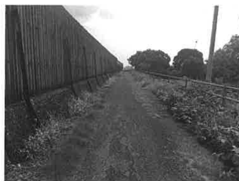
路面状況(舗装の割れ・雑草)
