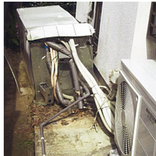
【熊本地震で転倒した電気給湯機】
