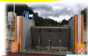
自動閉鎖型陸閘
