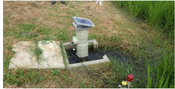
自動給水システム
