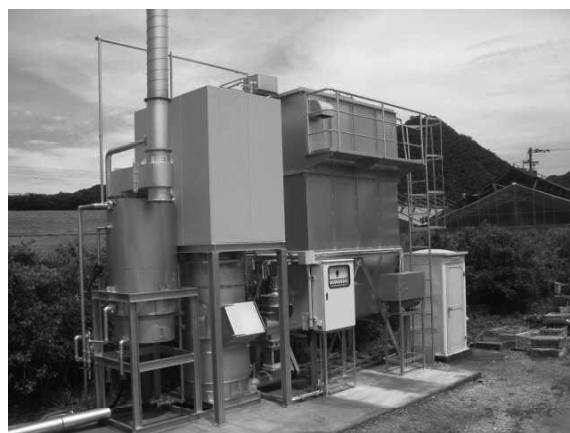
バイオマス小型熱交換炉
