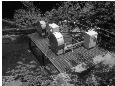
那賀町での小水力発電設備
