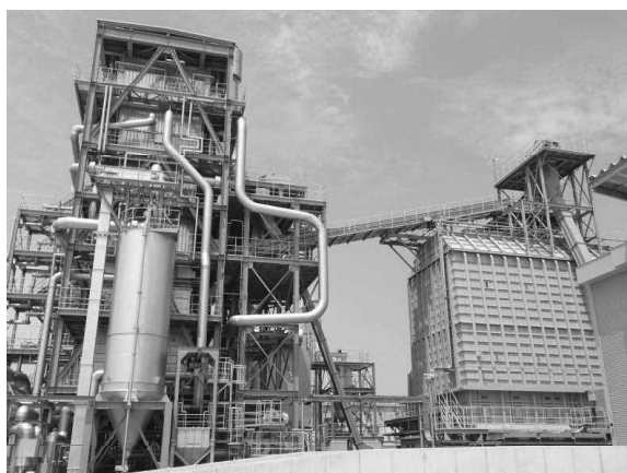
クラボウ徳島バイオマス発電所
