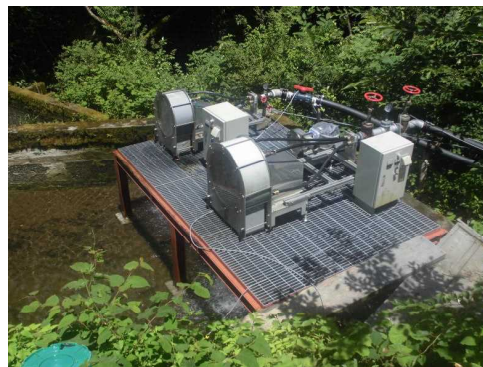
那賀町での小水力発電設備
