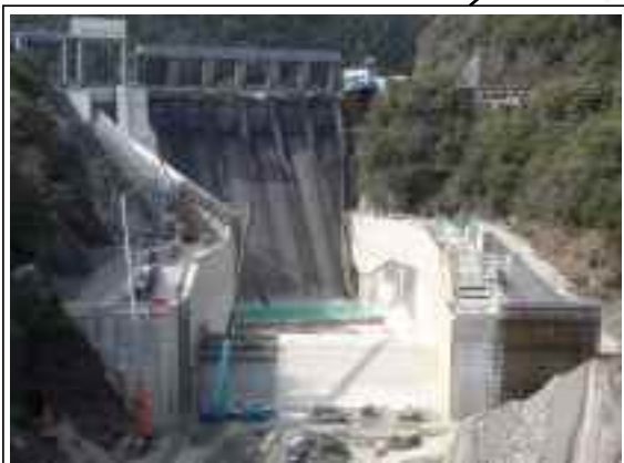
長安口ダム改造事業 新設洪水吐ゲート 令和元年度完成予定
