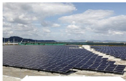
和田島太陽光発電所
