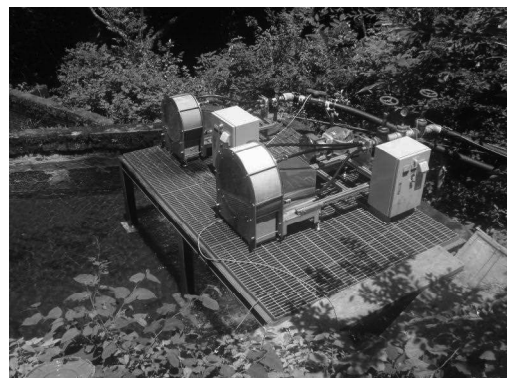
那賀町での小水力発電設備
