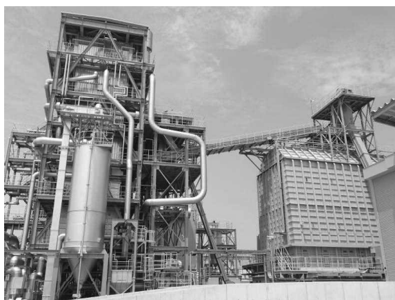
クラボウ徳島バイオマス発電所
