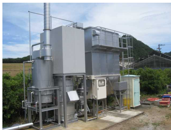
バイオマス小型熱交換炉
