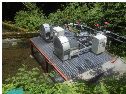
那賀町での小水力発電設備
