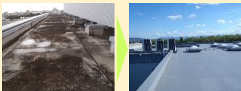
校舎 屋上防水の劣化
