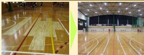
体育館 床の傷み
