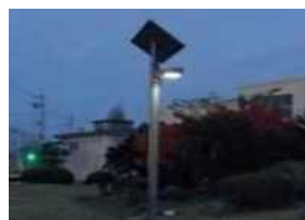
太陽光パネル付 LED照明灯
