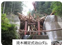
流木補足式治山ダム
