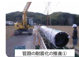
管路の耐震化の推進①
