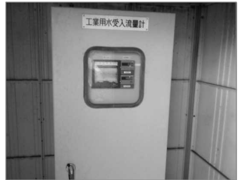
施策4-3 正確な水利用を把握するために設置された流量計
