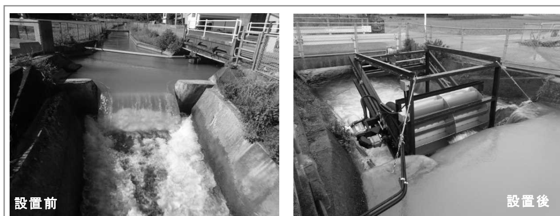
施策3-1 水路に設置した小水力発電装置(那賀川南岸土地改良区)
