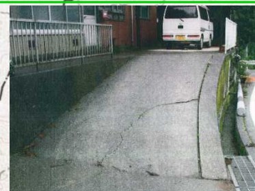
基礎コンの亀裂
