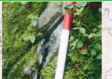
ブロック積の変状
