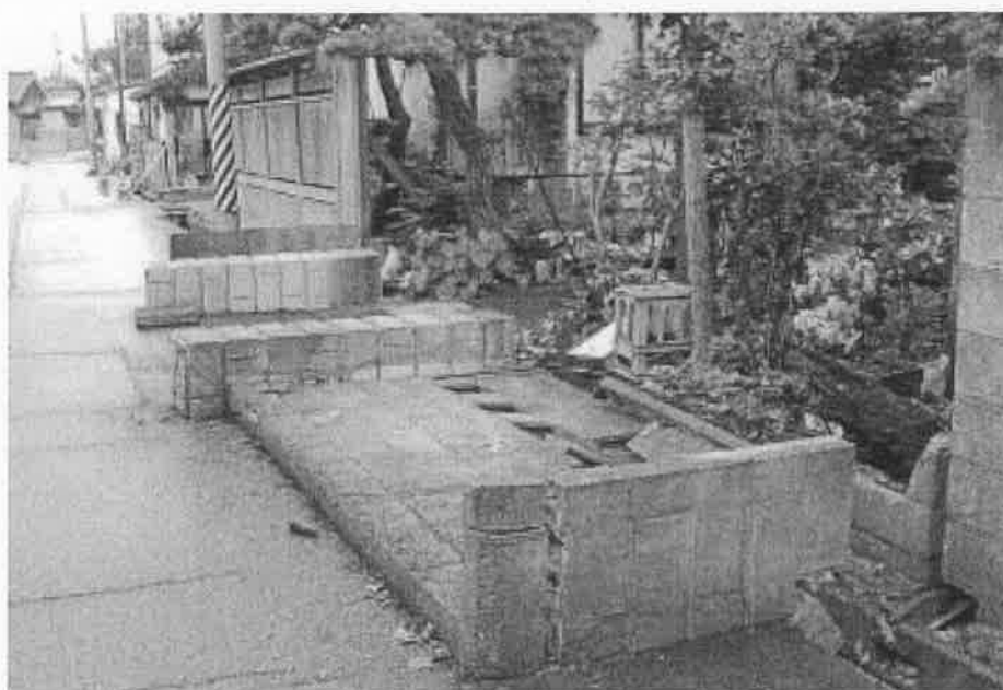
地震により、倒壊したブロック塀(平成19年新潟県中越沖地震) (写真提供：埼玉県)
