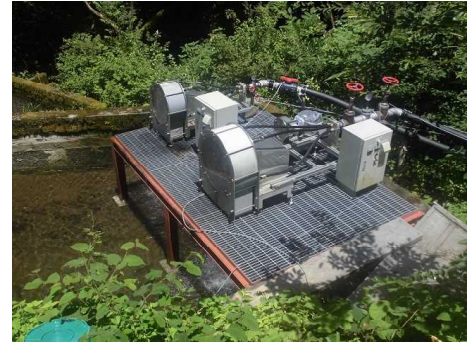
小水力発電（那賀町）
