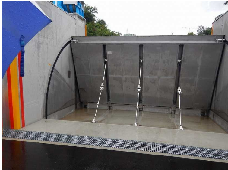
閉扉操作の自動化された陸こう
