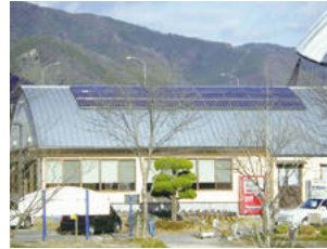
太陽光パネル設置施設
