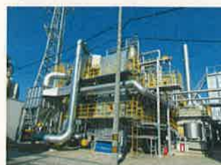
鶏ふんのエネルギー利用施設
