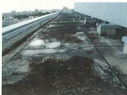
屋上防水保護コンクリートの劣化
