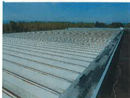
体育館折板屋根の錆
