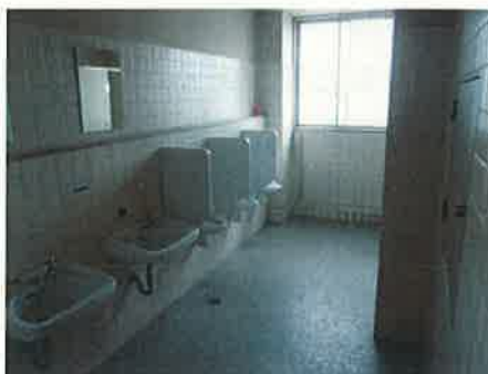
トイレ配管の経年劣化
