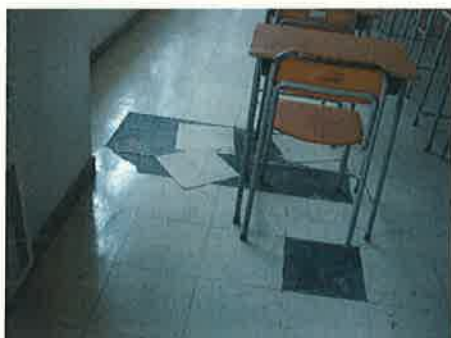
教室内部の床の剥がれ
