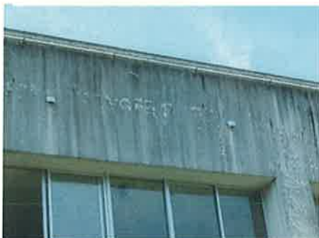
外壁の鉄筋の爆裂
