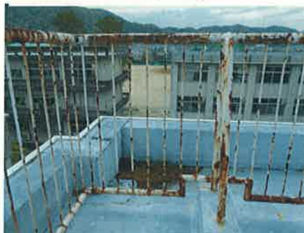
屋上手すり鉄部の錆
