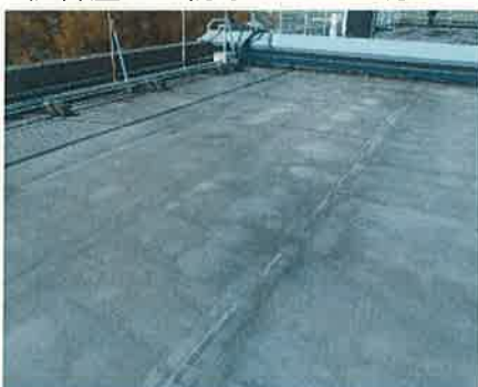
校舎屋上の防水シートの浮き
