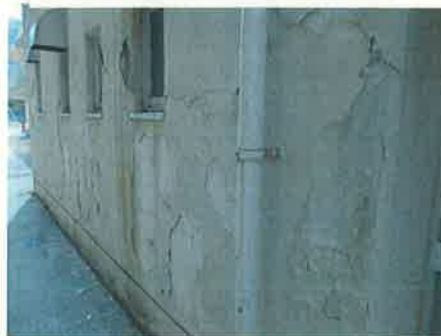
外壁の塗膜の広範囲の浮き
