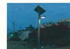
太陽光パネル付 LED照明灯
