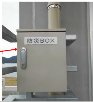
入口左側の防災BOX 震度5以上で解錠
