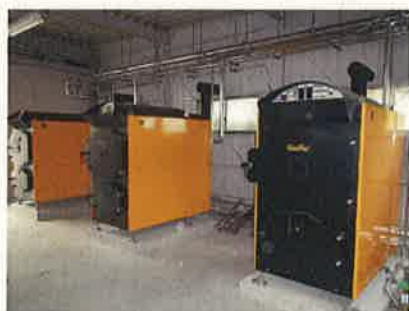
木質バイオマスボイラー
