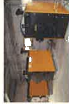
木質バイオマスボイラー
